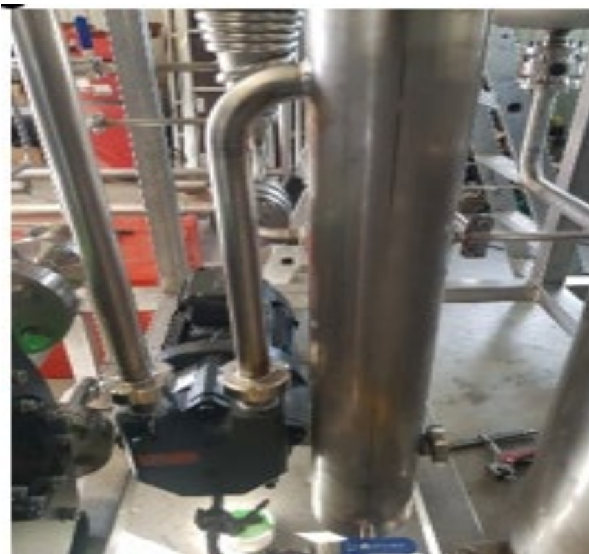
montajul pompei de vid
